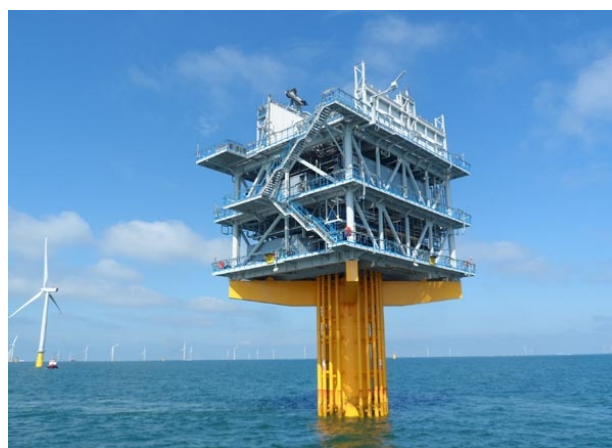
Оффшорная подстанция (фото London Array Ltd.).
